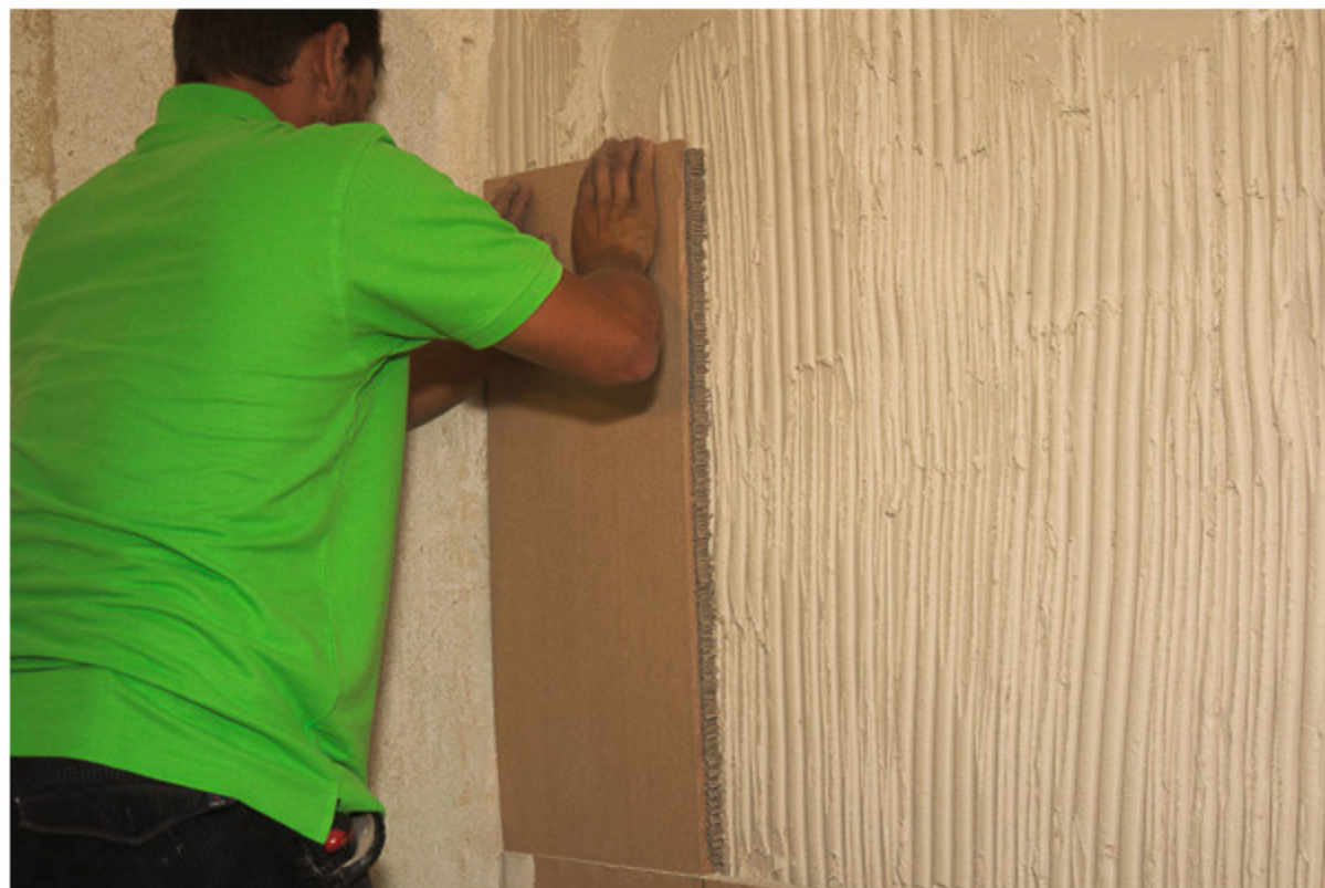
Die zugeschnittenen Dämmplatten werden in der Mörtelschicht verklebt. Dass sie nicht gedübelt werden müssen, ist besonders in Mietwohnungen ein großer Vorteil. Foto: UdiDämmsysteme
