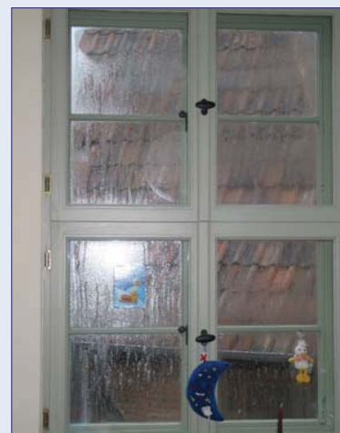
Abb. 146: Erheblicher Ausfall von Kondensat auf der Innenseite des äußeren Fensterglases, Nachweis der Undichtigkeit auf der Innenseite des Kastenfensters
