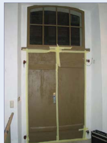
Abb. 128: Eingangstür zur Straße mit Abklebung der Fugen
