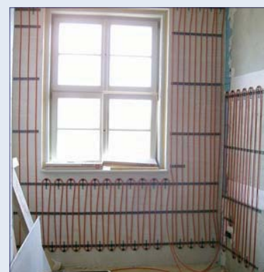
Abb. 51: Raumhohe Wandheizung in Wohnung 5
