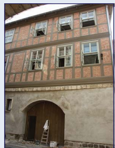
Abb. 21: Straßenfassade im August 2004, links zugemauerte Fensteröffnungen.
