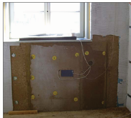
Abb. 186: Sensoren 3 und 4 sowie neues Kabel Sensor 2
