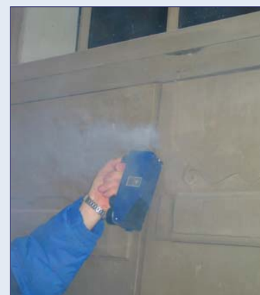
Abb. 127: Undichtheit an der Hauseingangstür zur Straße
