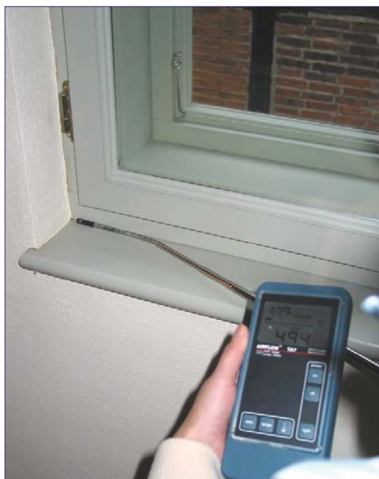
Abb. 131: Wohnung 2: Wohnzimmer Deutliche Undichtheiten am Fensterbrett
