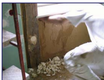
Abb. 41: Bauschaum muss wieder herausgekratzt werden
