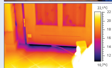
Abb. 125, 126: Terrassentür Küche Nord: kalte Luft strömt von außen durch die untere Fuge.
