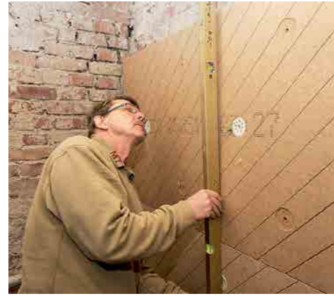
9 Wasserwaage, Richtsicht oder Schnurgerüst sind die bevorzugten Arbeitsmittel zum Ausrichten der Dämmplatten an den Innenwänden.
